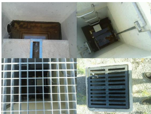
Regard aéré à eau libre
